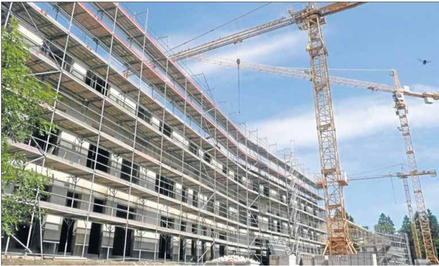
Ein imposantes Bauwerk, umgeben von acht Kränen, entsteht auf der grünen Wiese: Das Rehaszentrum Oberharz wird einmal Platz für 280 Patienten bieten und die beiden alten Fachkliniken für Onkologie und Psychosomatik (Erbrinzentanne und Am Hasenbach) ablösen. Fotos: Böhl
