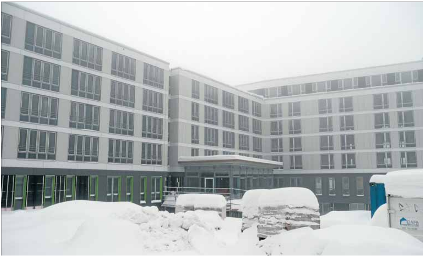
Zeitig winterfest gemacht: Neubau des Reha-zentrums am Schwarzenbacher Teich. Hinter der Fassade des 49 Millionen Euro teuren Gebäubekomplexes treiben Handwerker den Innenausbau voran. Im Juli soll die moderne Klinik eröffnet werden. Foto: Böhl
